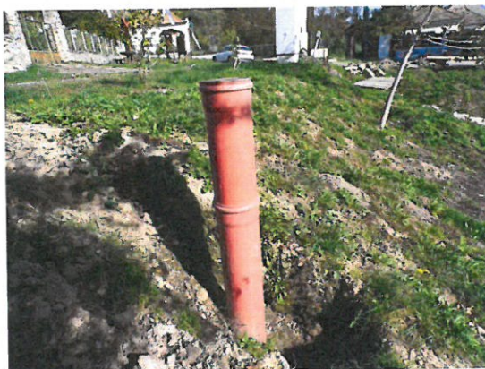
A bérlő által bevezetett csatorna közmű az értékelt telken
